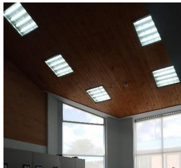
Fotografía N°62. Fuentes de iluminación natural y artificial.
