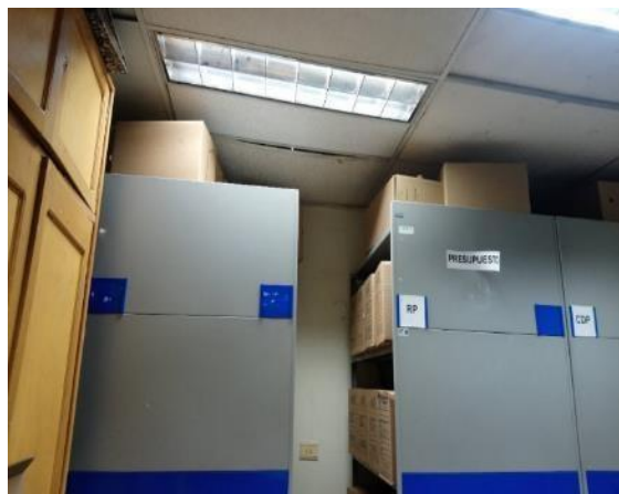
Fotografía N°2. Deterioros de techo. Archivo URF.
