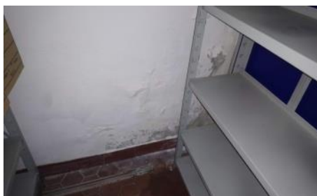
Fotografía N°75. Deterioro en muros por humedad.
