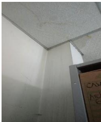
Fotografía N°3. Escurremientos. Gestión documental
