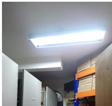
Fotografía N°78. Luminarias del archivo.
