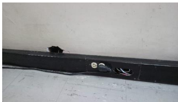
Fotografía N°5. Cableado sin protección. Archivo Fondo Originales.
