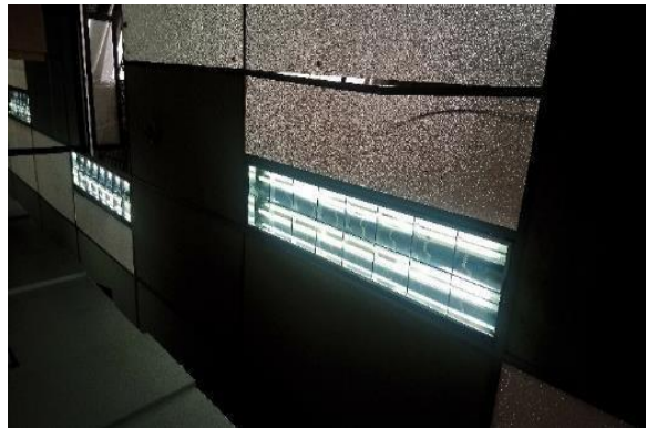
Fotografía N°4. Faltante y deterior en techo. Gestión documental
