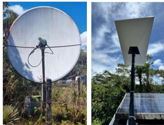
Imagen 2. Modernización de la infraestructura de comunicaciones Izquierda. Antena satelital banda C. Derecha. Antena satelital LEO.
