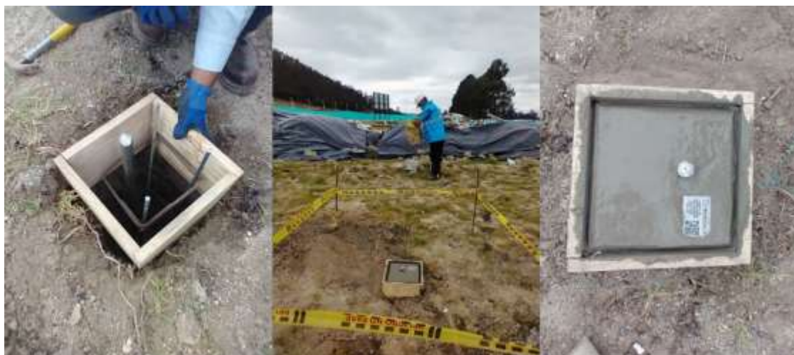
Figura 128. Estación de referencia vertical en PTAR Canoas
