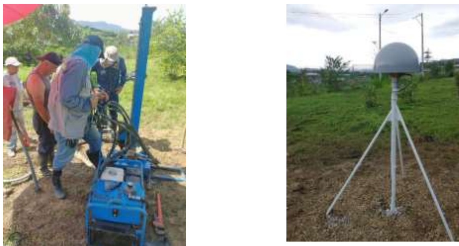
Figura 124. Instalación estación en San Juan Nepomuceno. Perforación (izq) e instalación de antena (der).
