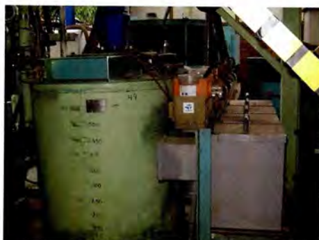
Figura 8.1. Unidad de tratamiento de la pulpa residual del proceso de beneficio.
