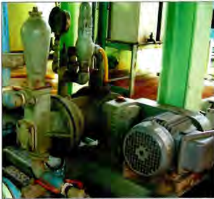
Figura 5.8. Bomba del tanque de pulpa lixiviada.
