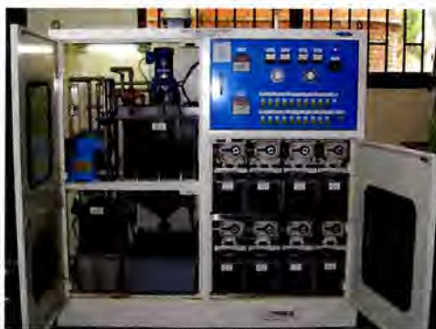
Figura 13.4. Planta de tratamiento de aguas residuales de laboratorio.
