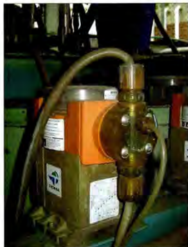
Figura 8.8. Bomba de los tanques de NaOH, H 2 SO 4 , NaOCl, floculante.
