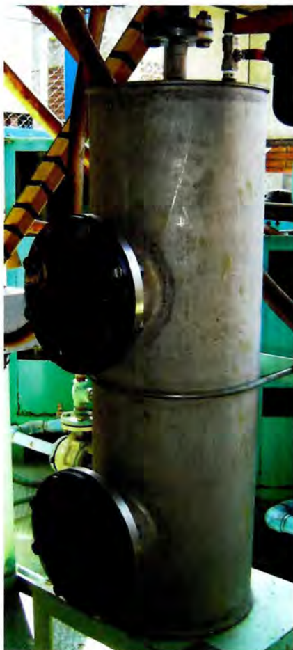
Figura 7.4. Filtro de arena.
