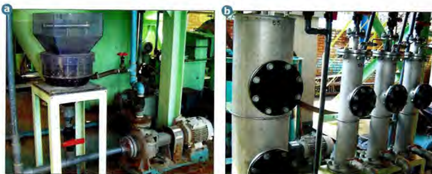
Figura 7.1. Unidad de precipitación y adsorción de oro: a. Sistema Merrill Crowe. b. Columnas de adsorción.
