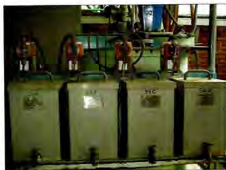
Figura 8.6. Tanques de almacenamiento de reactivos químicos para tratamiento de residuos (NaOH, H 2 SO 4 , NaOCl, floculante.)
