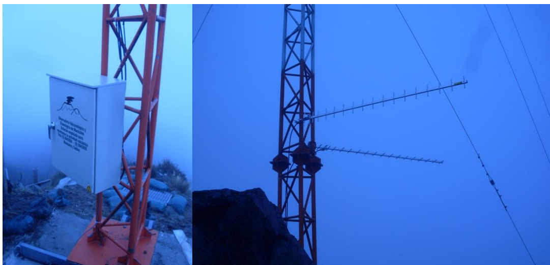
Figura 86. Repetidor Cerro Bravo.
