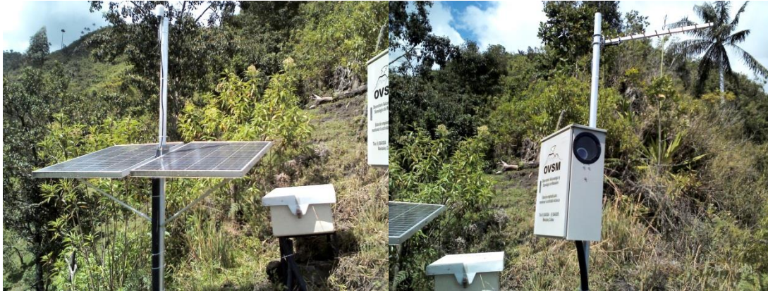
Figura 65. Estación Banda Ancha y Cámara TOCHE.
