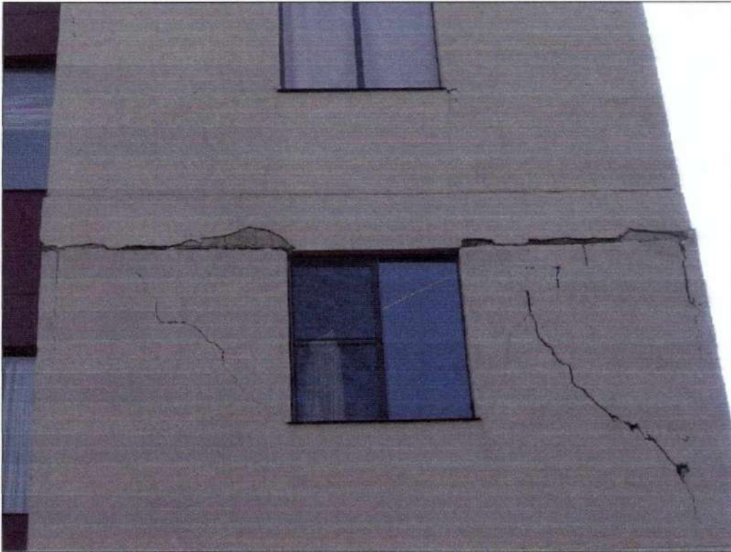
Fotografía 3.2 _Daño Moderado presentando fisuras y agrietamientos con alguna regularidad con desprendimiento de material en muros de la edificación.
