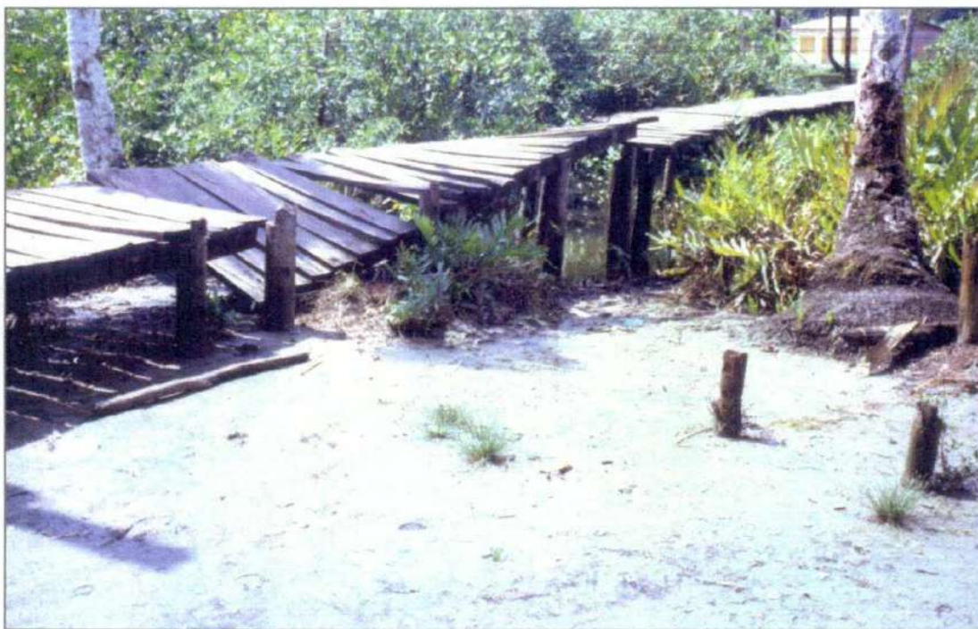
Fotografía 2.1. Efectos por la sacudida del terreno sobre un puente en la localidad de Usaragá
