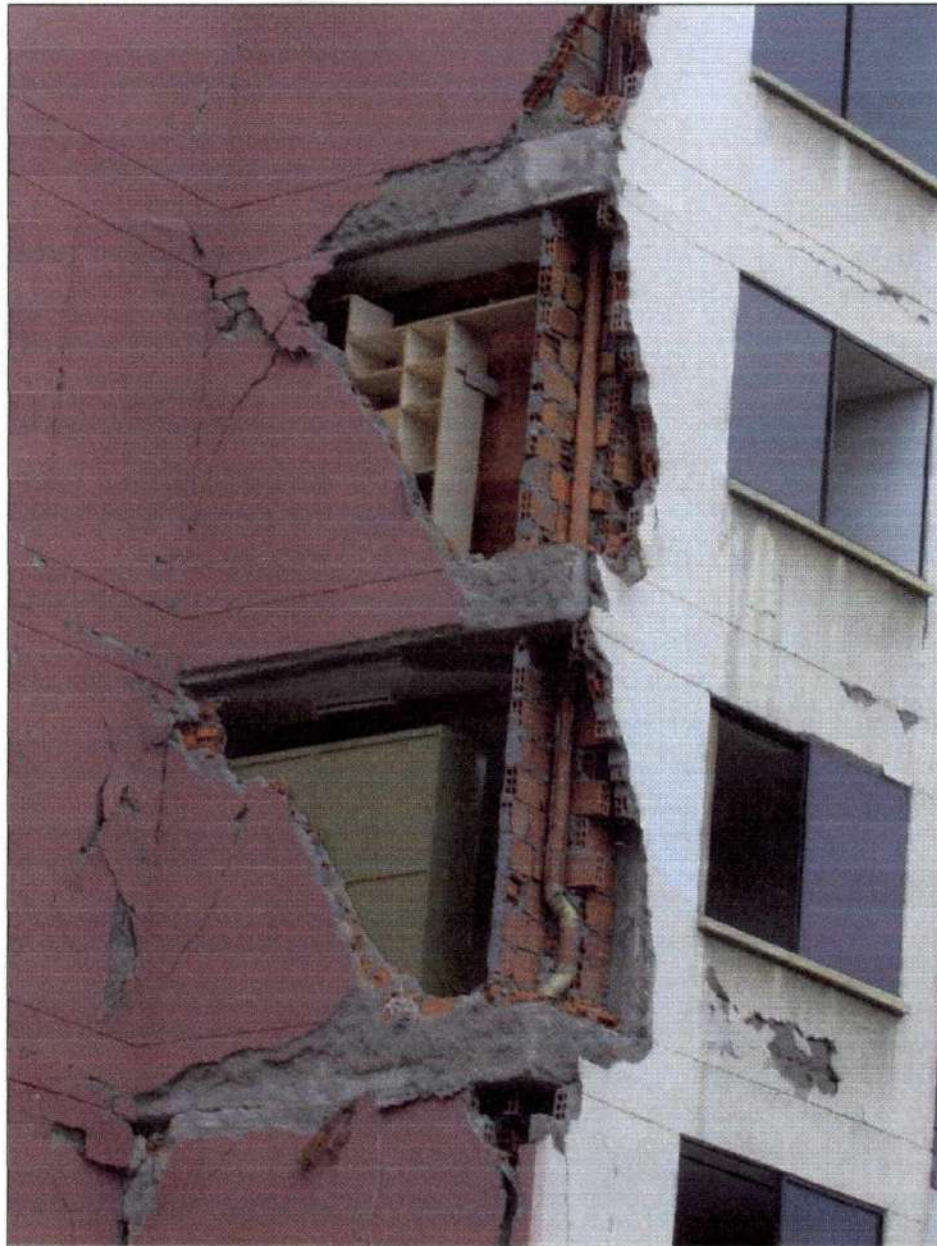
Fotografía 3.3 Daño Severo en la edificación con agrietamientos de aberturas apreciables, caídas de muros y fachadas.
