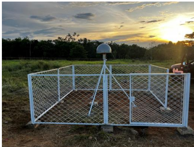
Estación cGNSS de operación continua PRIC - Puerto Rico (Caquetá)
