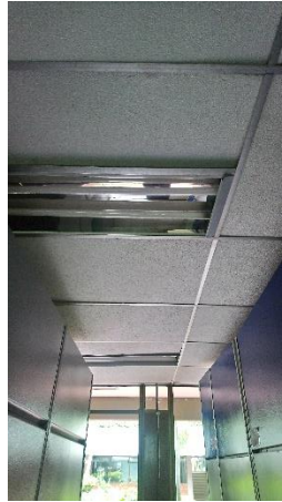
Fotografía N°34. Iluminación natural, lámparas apagadas.
