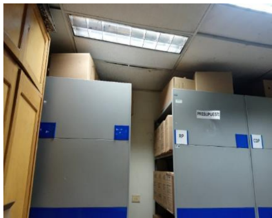
Fotografía N°2. Deterioros de techo. Archivo URF.
