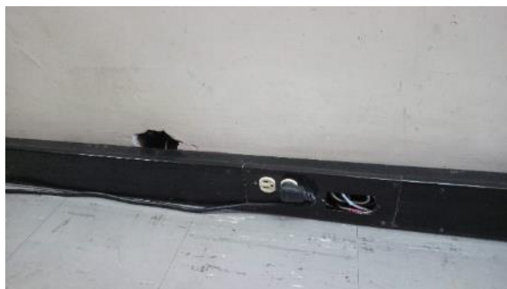
Fotografía N°5. Cableado sin protección. Archivo Fondo Originales.
