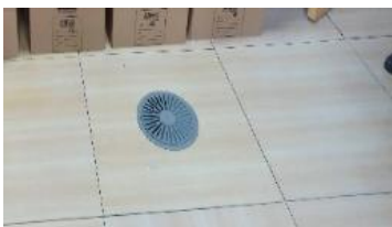
Fotografía N°14. Rejilla de ventilación en el piso
