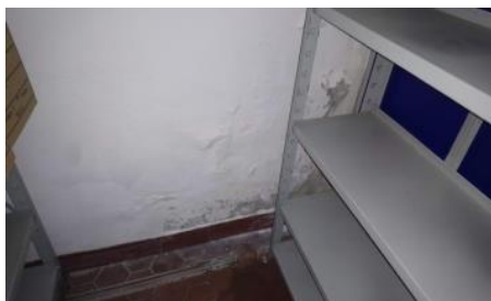
Fotografía N°75. Deterioro en muros por humedad.
