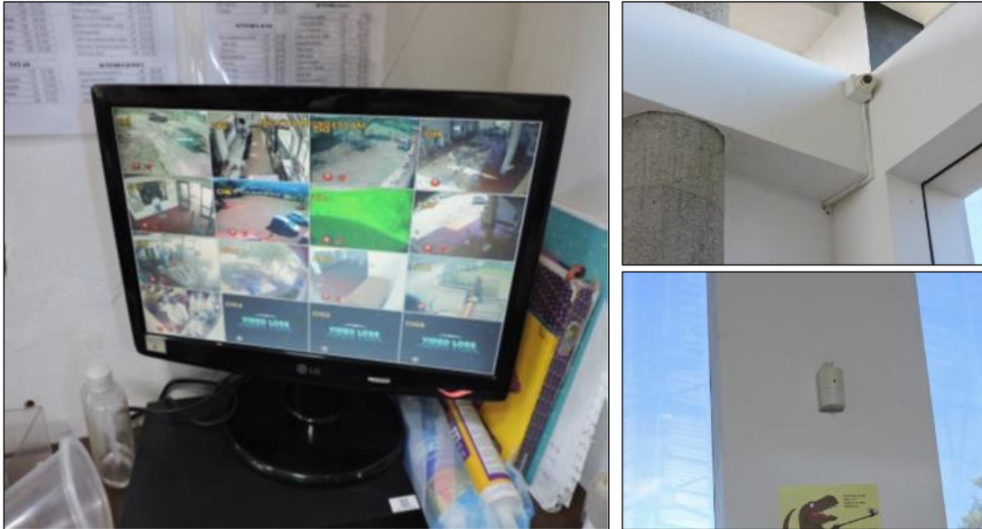
Figura 27. Sistema de monitoreo, cámaras y sensores de ruido y movimiento
